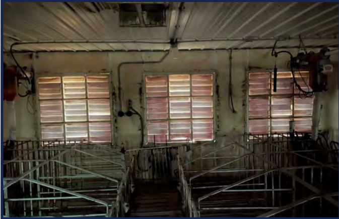
Gestation Fan End Wall
