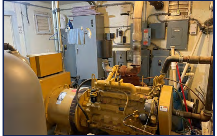
100KW Site Generator
