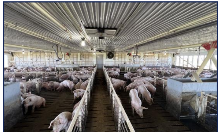
Tunnel Fan End
