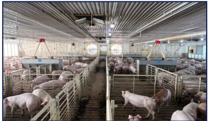
Tunnel Fan End
