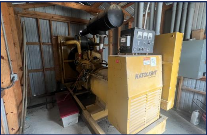
Site 350KW Generator
